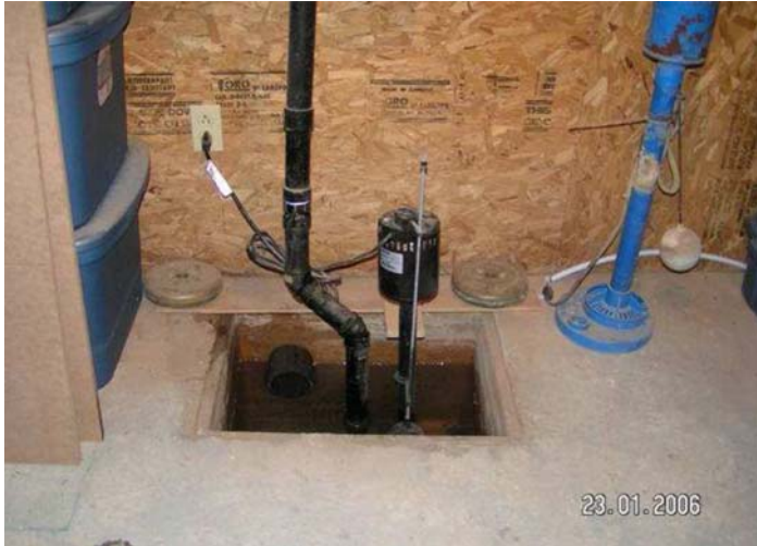
Fosse de retenue et pompe éléatoire
